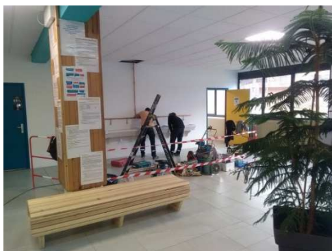
L'installation de points d'eau, dans le hall En amont de l'entrée au restaurant scolaire
